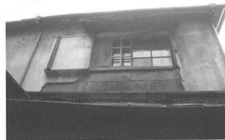
モルタルが剥落した下から鉄板が見えています。その下には木製の下見板が残っています。
